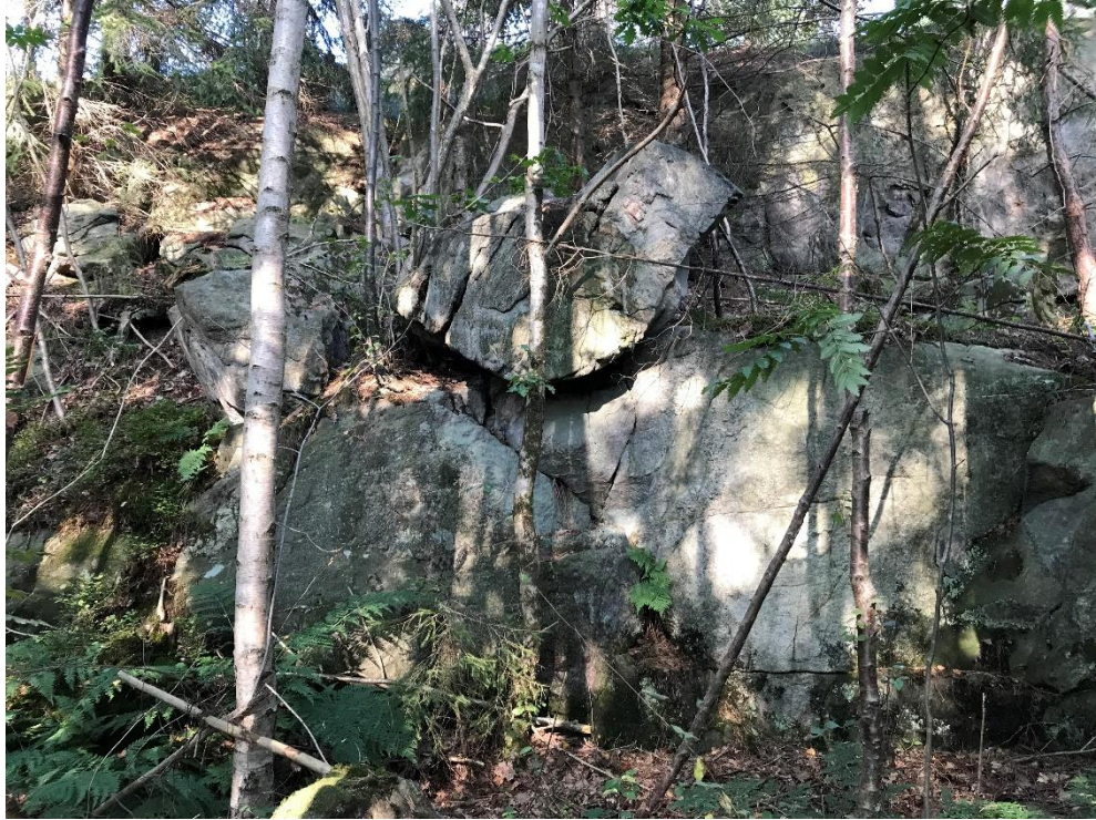
Figur 19 Löst block i slänten öster om Röra byväg som på sikt riskerar att rasa ned. Blocket fångas upp av marken nedanför (COWI, 2022-08-19).
