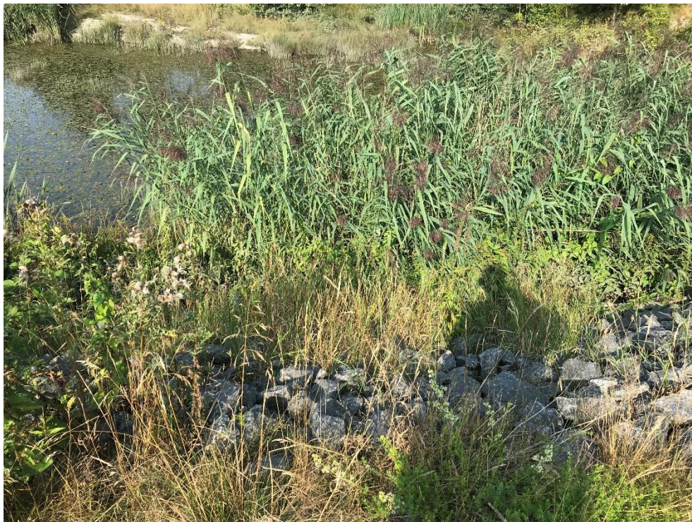
Figur 15 Dammen fotad från östra banken, som består av sprängstensfyllning. Berg i dagen vid vattenbrynet på andra sidan dammen syns i bakgrunden (COWI, 2022-08-19).
